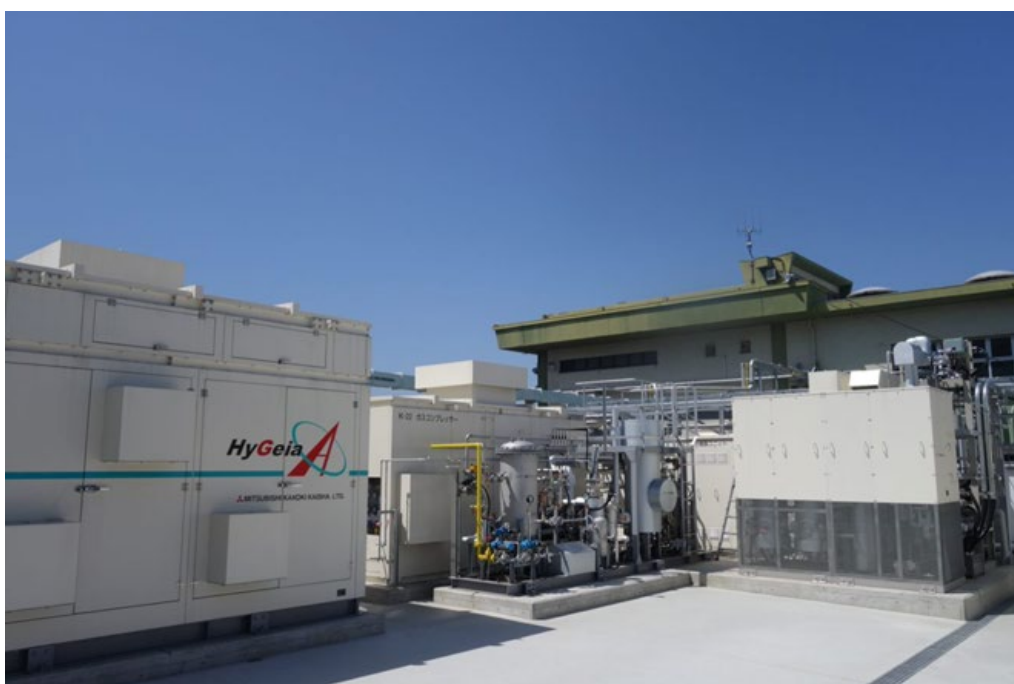
福岡市 水素製造設備
