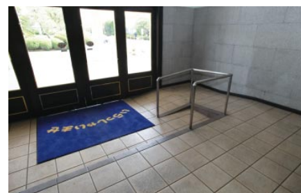
本工場本館の入口に設置された車椅子用スロープ
