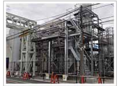
群馬製作所 本工場コージェネレーションシステム
