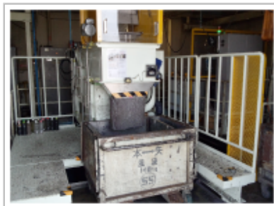
塗料カス回収装置
