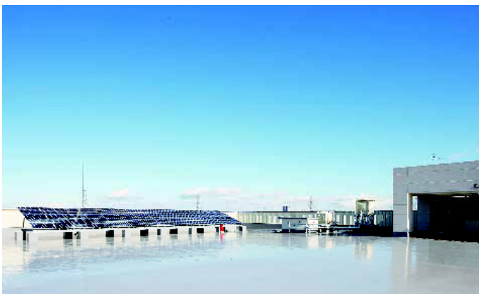
新事務所本館の屋上に設置している太陽光発電
