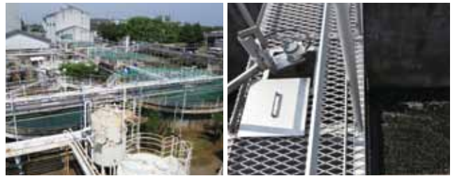
排水処理設備
