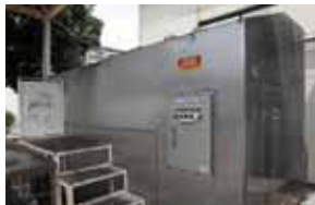
コンポスト処理設備
