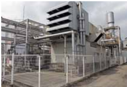
コージェネレーション設備
