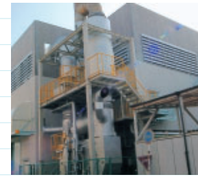
宇都宮製作所が導入した、天然ガスコージェネレーションシステム
